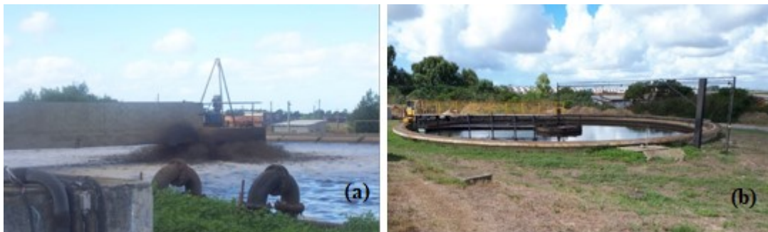
Figura 1. Tanque de aeração (a) e decantador secundário (b) da ETE Parque Marinha.
