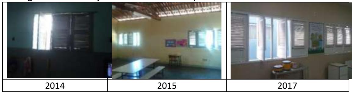
Figura 18: Portas e janelas da Escola Municipal Francelino José do Nascimento
