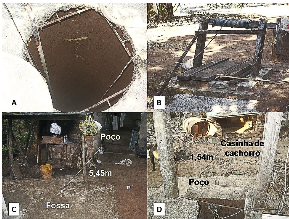
Figura 1 – Irregularidades verificadas na construção e manutenção de poços que servem como fonte de água subterrânea para moradores do município de Lagoa Santa – MG. A – Poço com ausência de revestimento interno; B – Poço com tampa de madeira apresentando frestas que permitem a passagem de sujidades e contaminantes; C – poço construído a uma distância de 5,45m da fossa séptica; D – Poço sem cobertura localizado próximo a fontes de contaminação externa (animais e abrigos de animais).
